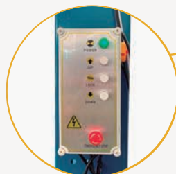
Painel de acionamento e destrava elétrica para descida
